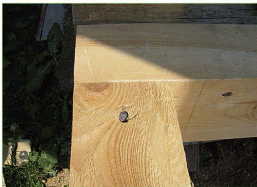
Во внутренних углах поперечные брусья обвязки крепятся к продольному брусу встык на шипах из прутков арматуры.
