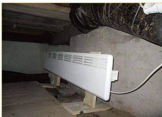
Электрический конвектор в холодные зимние дни обогревает подполье в автоматическом режиме. При снижении температуры до 4–8°C включится нагрев.
